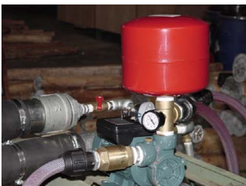
Figura 2. Bomba hidroneumática del tipo doméstico
