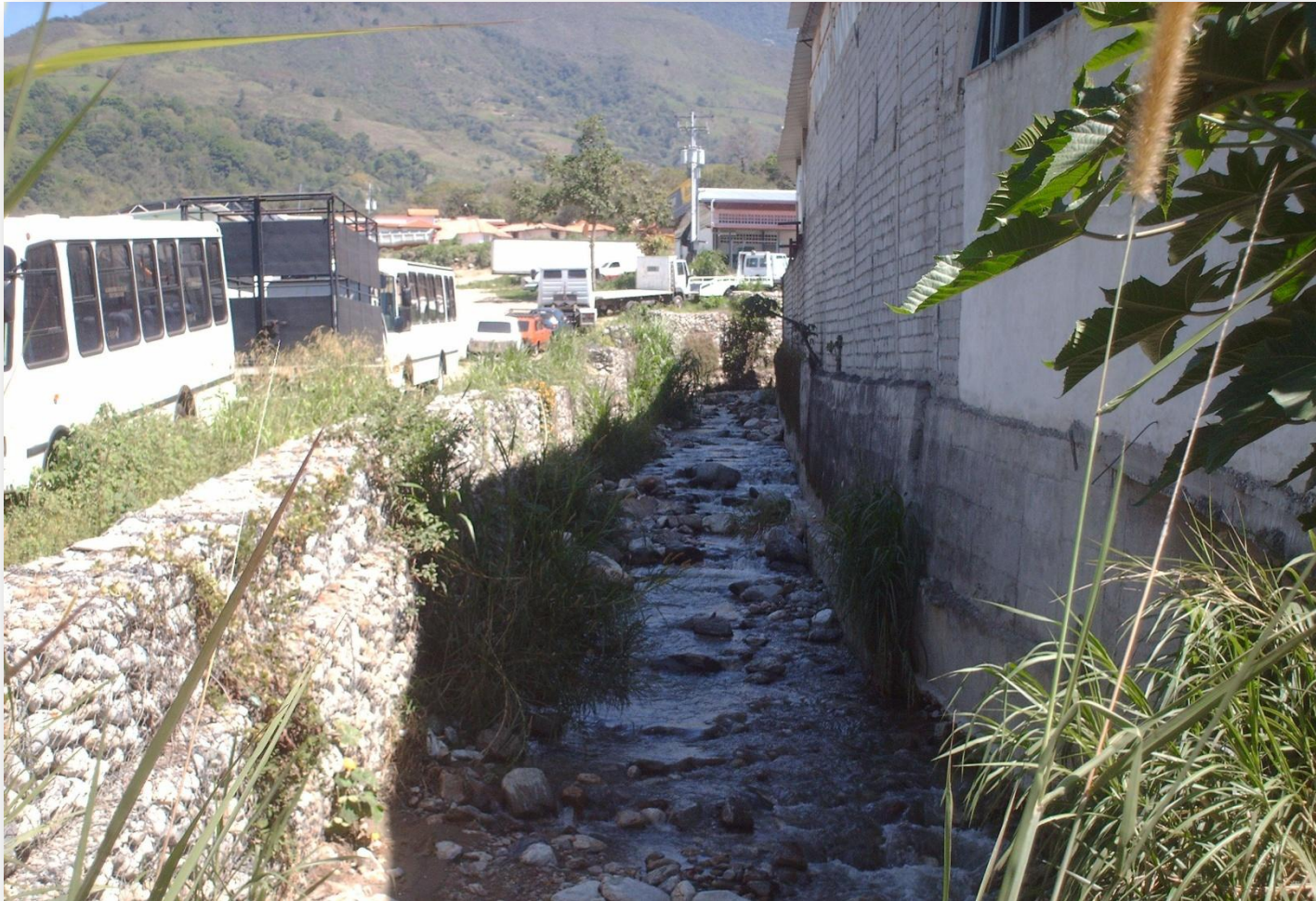
Muro longitudinal de gaviones, quebrada La Resbalosa. Fotografía tomada por A. Moreno, 2011
