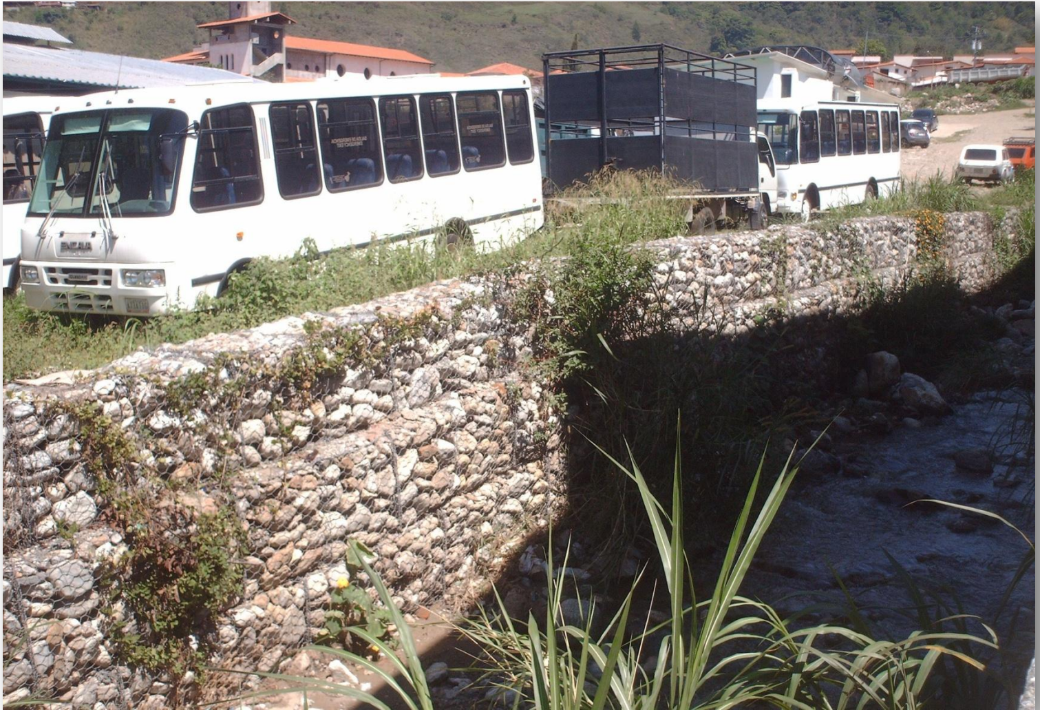
Muro longitudinal de gaviones, quebrada La Resbalosa. Fotografía tomada por A. Moreno, 2011
