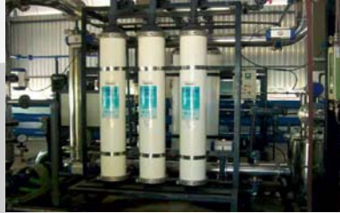
Fig. 5 Bateria de Ultrafiltración para tratar efluentes
